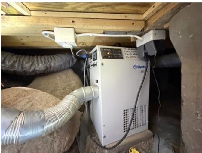
Avfuktare i grunden
